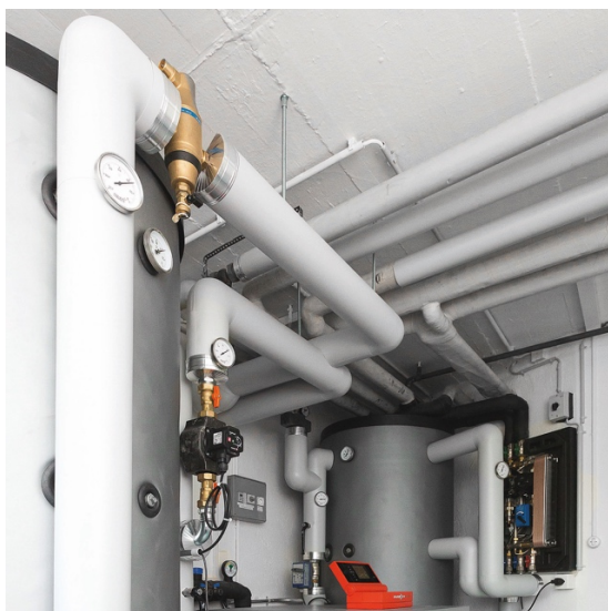
Impianti per l'efficienza energetica
