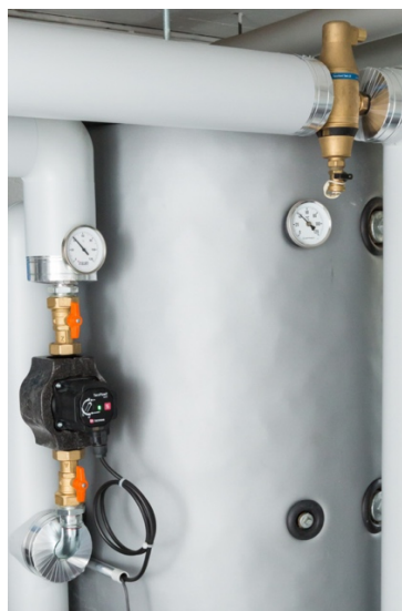
Impianti per l'efficienza energetica
